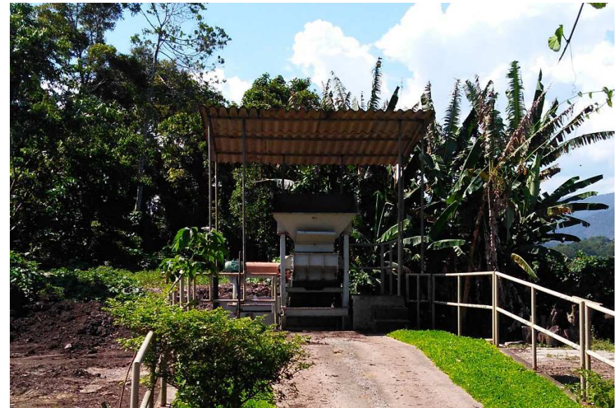
Galpão que abriga o peneirador de resíduos
